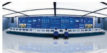
中国巨石玻璃纤维智能化中控室
