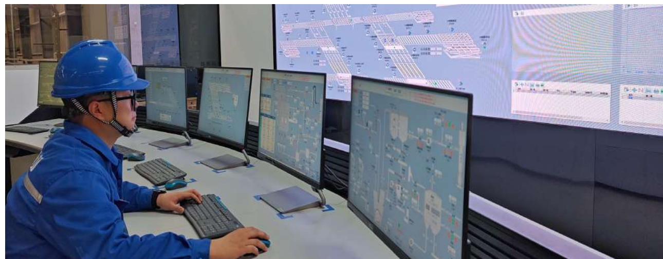
龙牌公司天津基地智能控制中心
