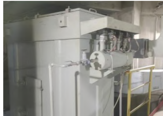
改造后的收尘系统
