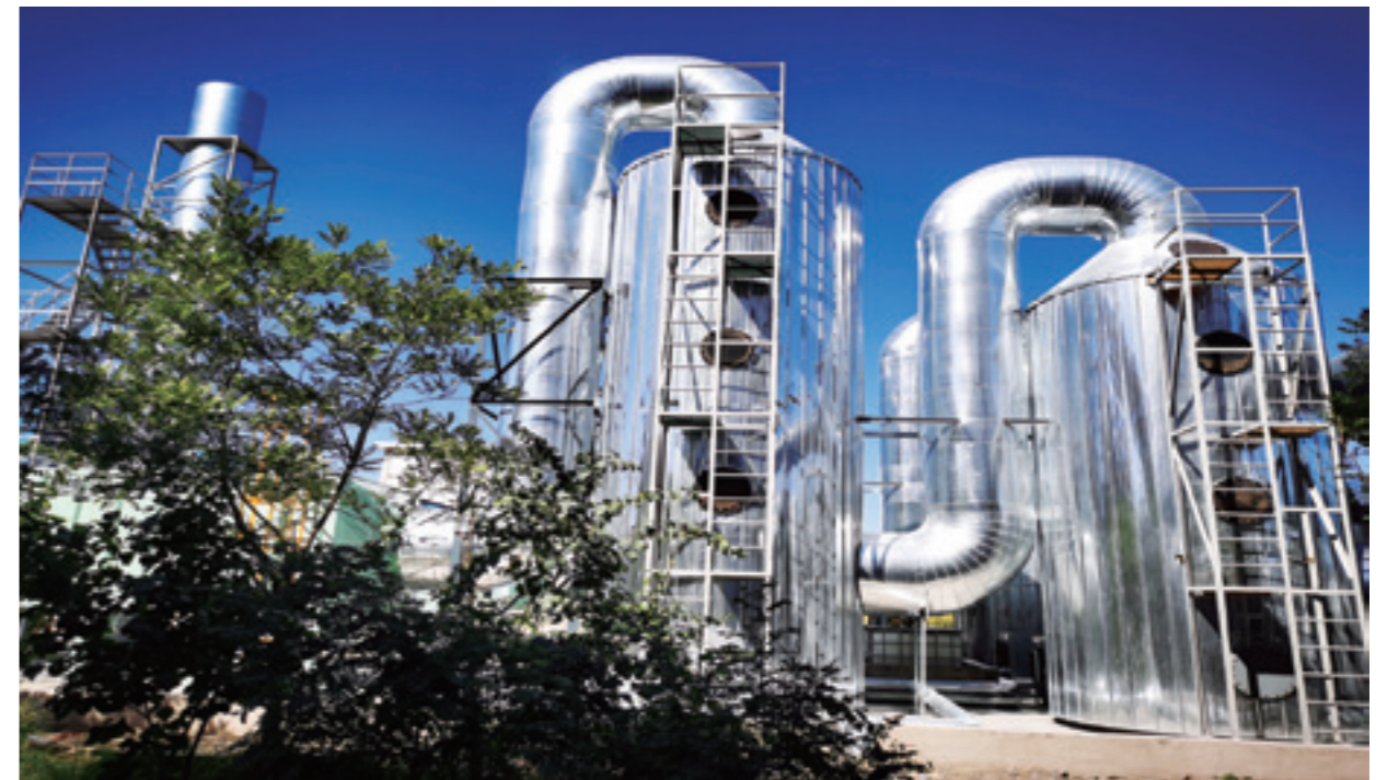
嘉峪关祁连山水泥公司水泥窑协同处置废气处理装置
