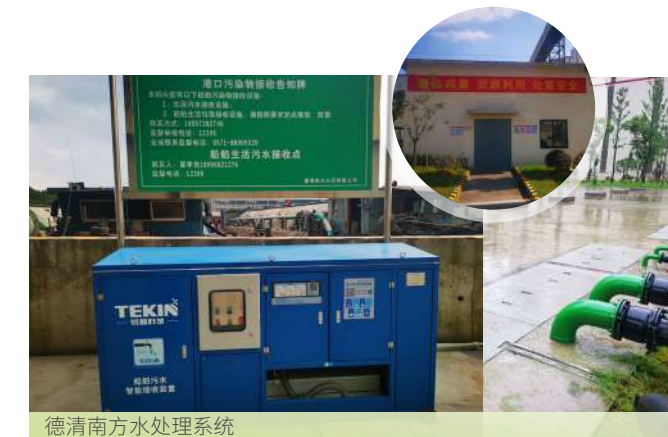
德清南方水处理系统
